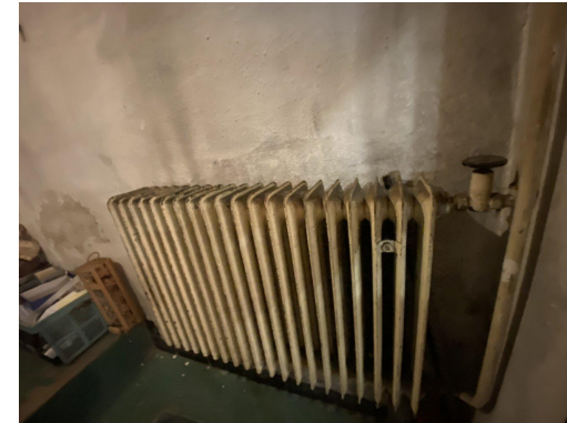
radiátor v technické místnosti
