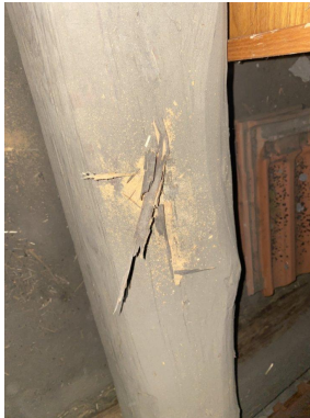
Střecha krov biotické poškození
