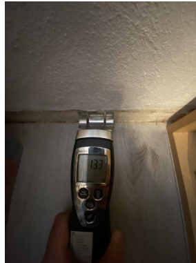
Měření vlhkosti stěn interiér - 13%
