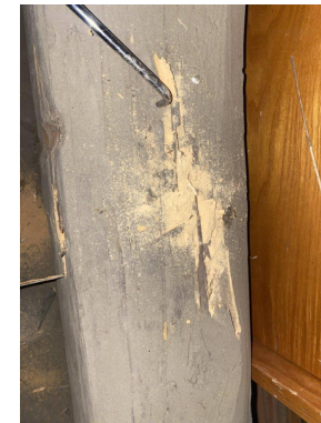
Střecha krov biotické poškození
