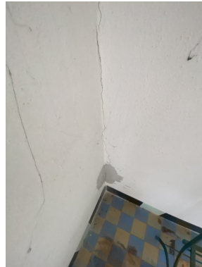
Trhliny ve zdivu
