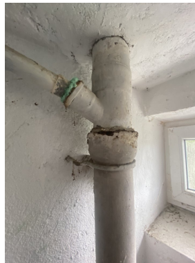
Kanalizační potrubí ve sklepě
