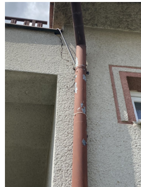
Trhliny ve zdivu
