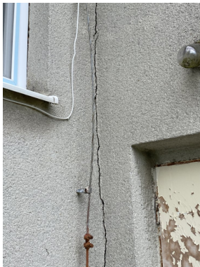
Trhliny ve zdivu
