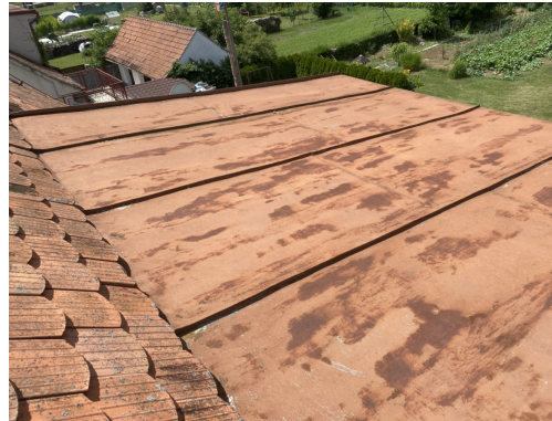
Střešní krytina plech - koroze
