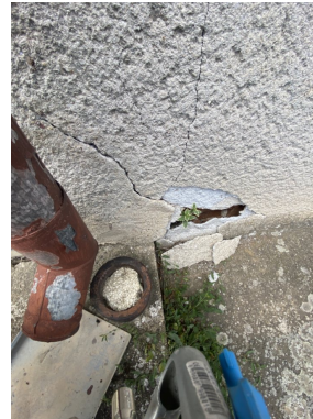
Poškozená fasáda, ucpání dešťové kanalizace
