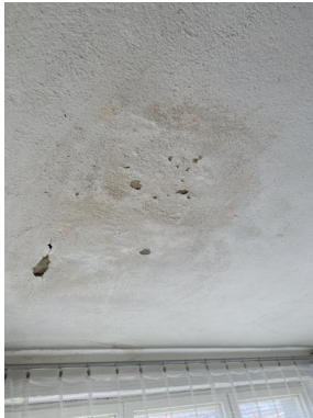
Zatečení do stropu v předsíni
