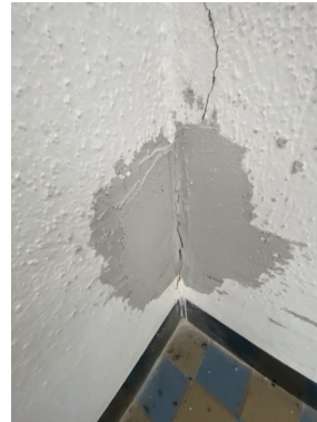
Trhliny ve zdivu
