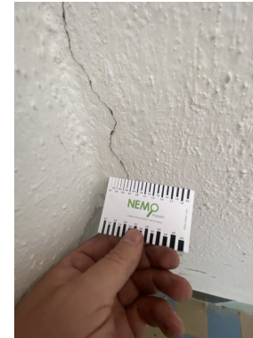
Trhliny ve zdivu
